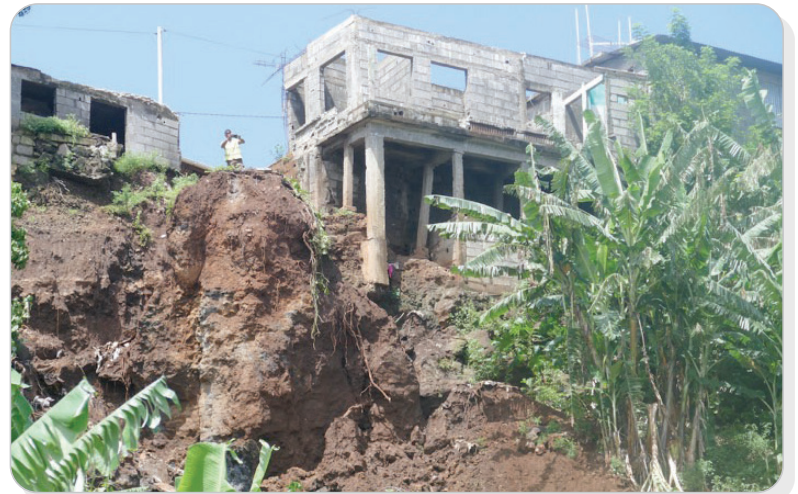
Eboulement de terrain à Majcavo Koropa (2018) - mayotte.orange.fr
